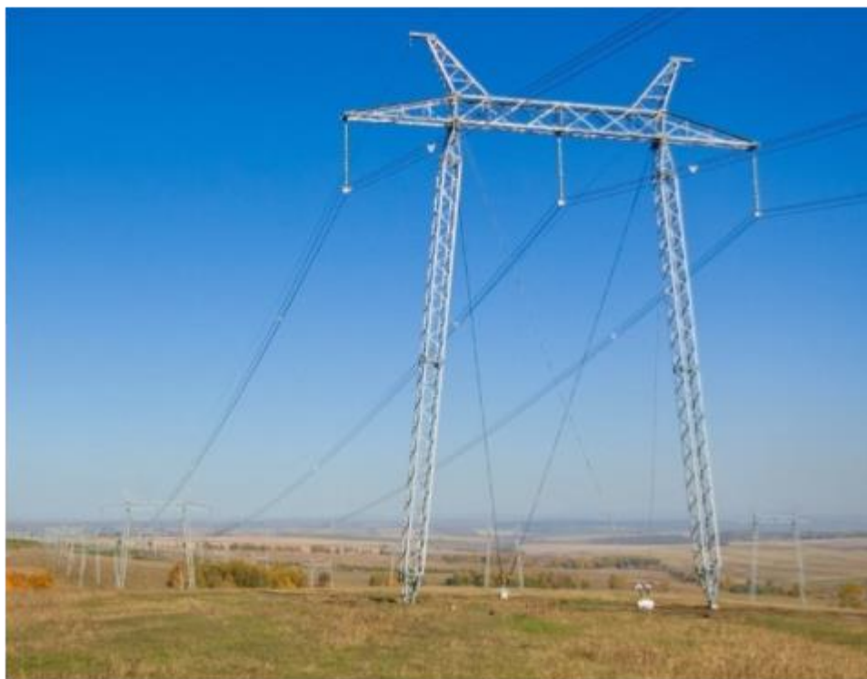
Рис. 1. Линия электропередач напряжением 500 килвольт
